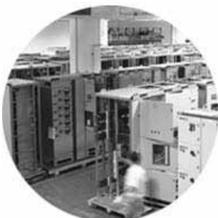
厦门ABB生产车间
